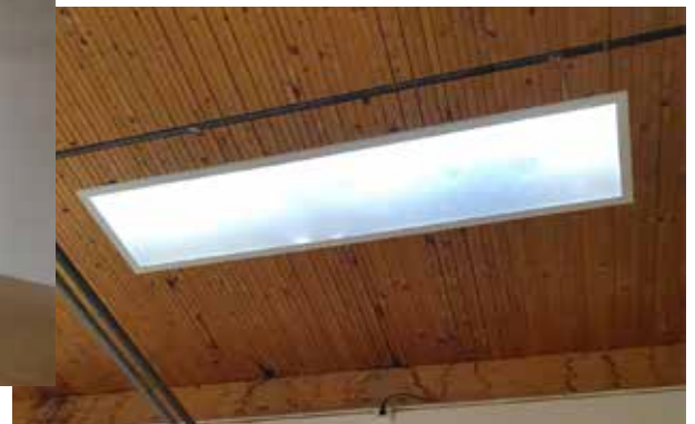
Wasser in der Lampe
