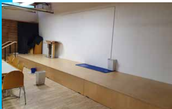
Wasser vom Saaldach an mehreren Stellen
